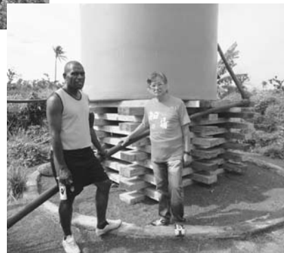
新しく設置されたウォータータンク
